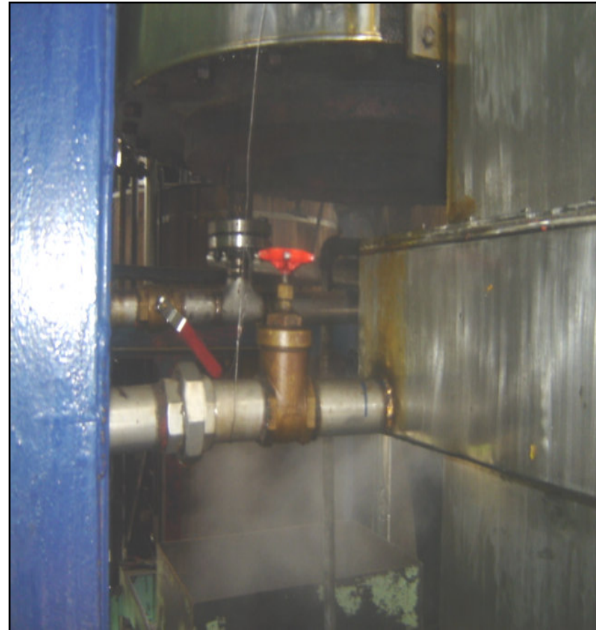
Drenajes de aceite Digestor S. Elena
