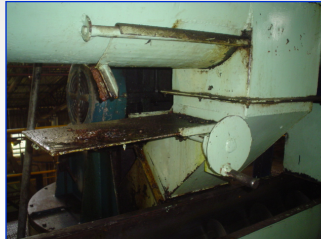
Compuerta del Digestor
